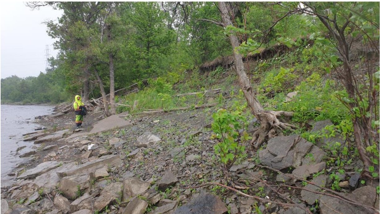
Figure 35 Tronçon 1129 vue des berges fortement érodées jusque dans leur partie supérieure, dans le parc du Bois-de-Liesse.
