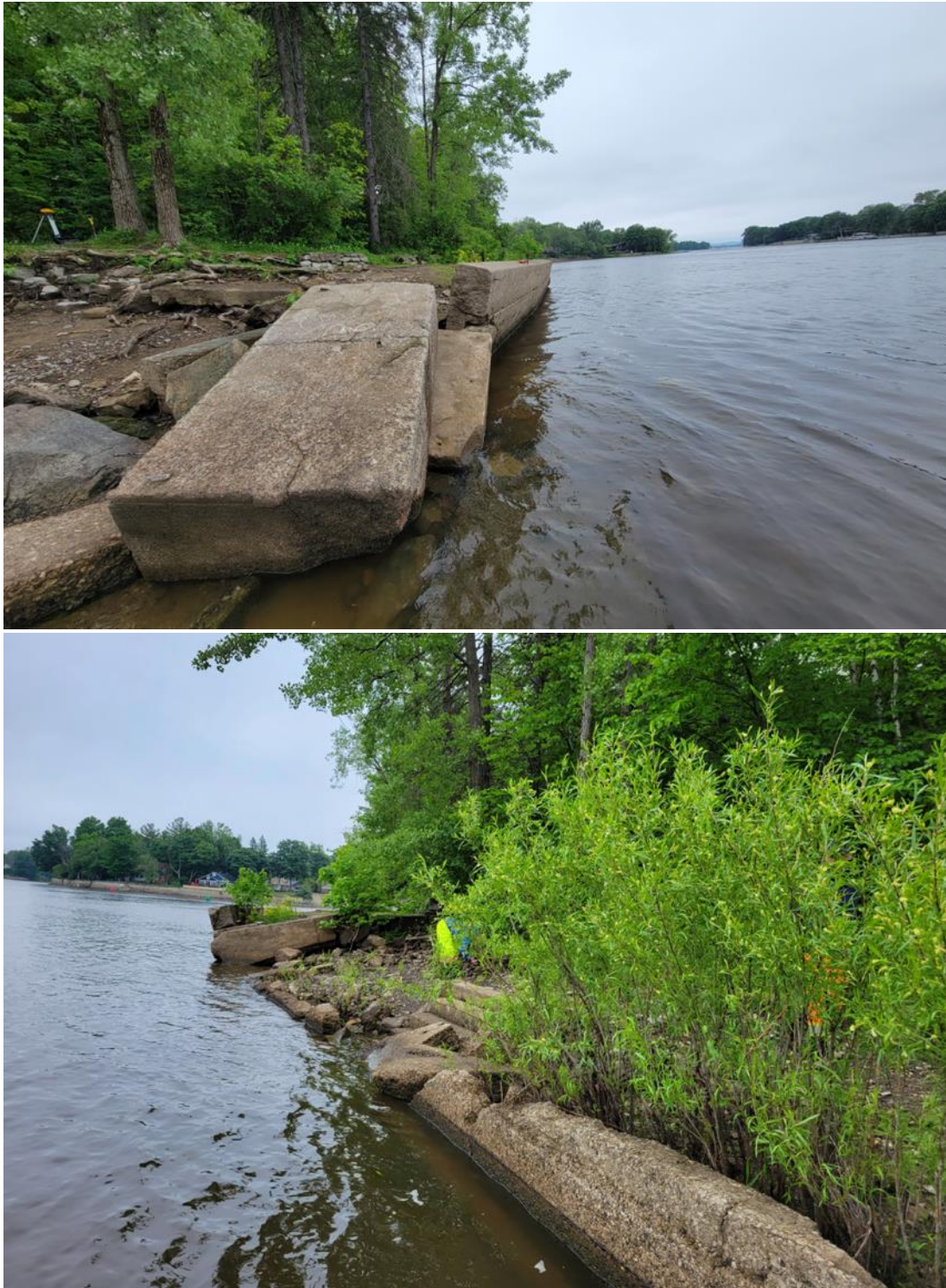
Figure 32 Mur de béton dégradé présent au tronçon 1176 du parc de l'Île-Bizard. La photo du bas montre la rangée de Salix interior derrière une section du mur.
