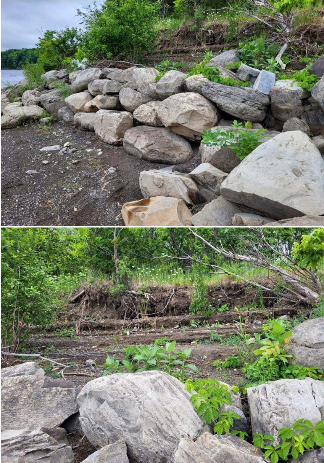
Figure 34 Tronçon 1136 avec vue de l'empierrement existant et du haut de talus érodé, dans le parc du Bois-de-Liesse.
