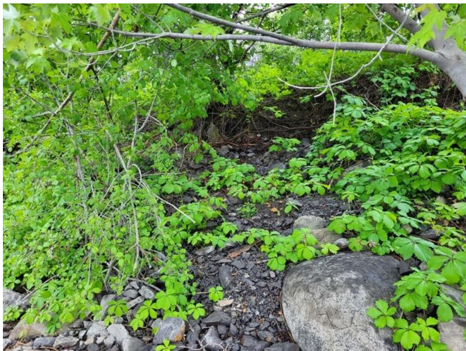
Figure 25 Partie haute du talus fortement érodée pour le tronçon 1079, secteur de l'accueil du parc du Cap-Saint-Jacques.
