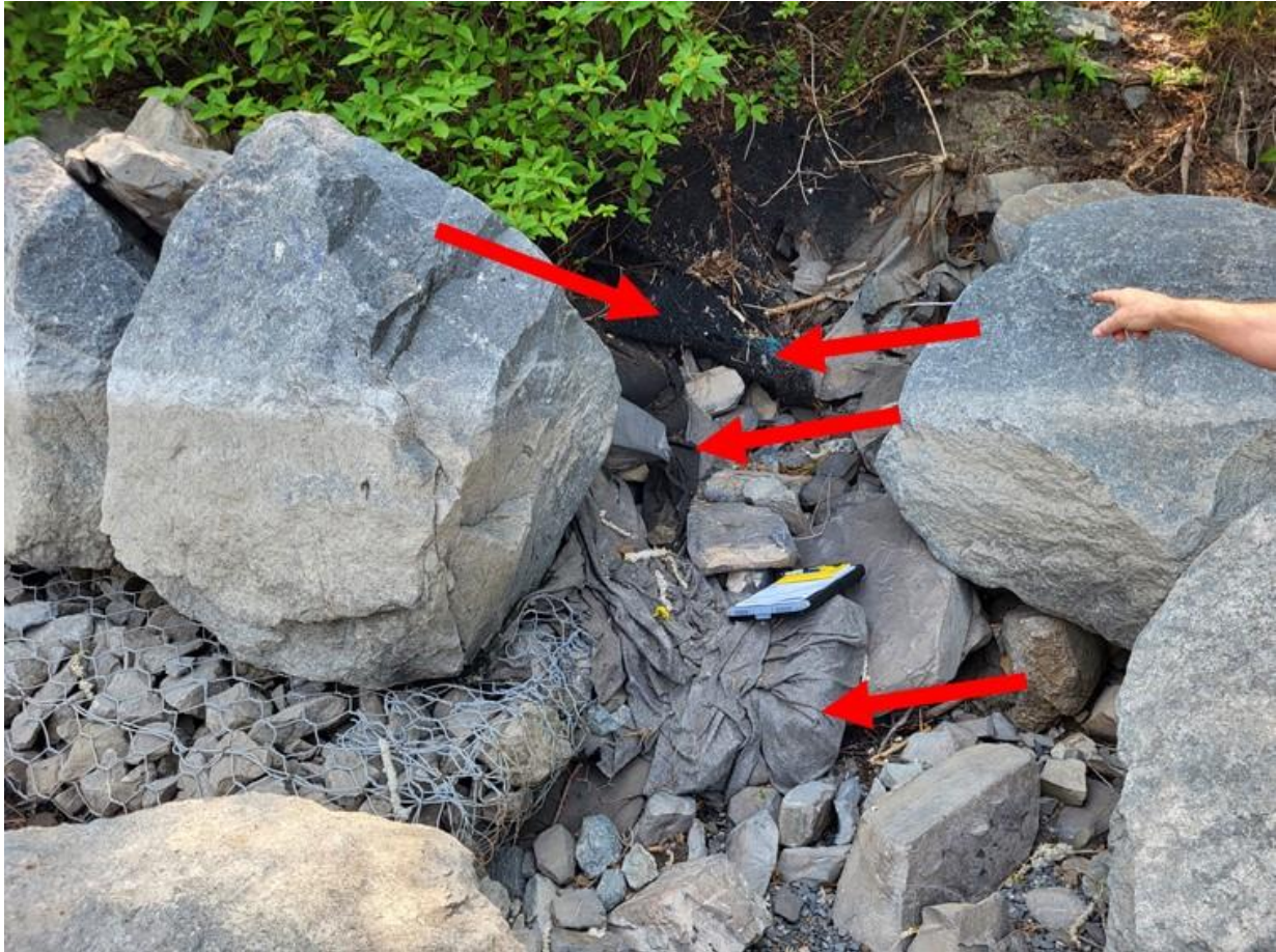
Figure 37 Présence de quatre géotextiles de plastique différents au parc Promenade-Bellerive.
